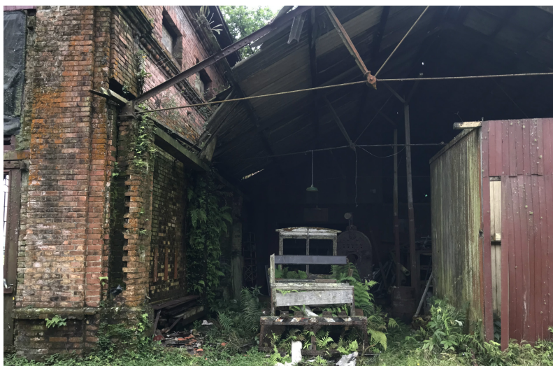
◇ Conjunto - 4ª Máquina - Vista para área interna do "Galpão"
