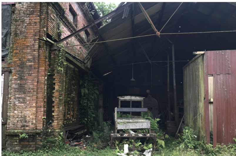
◇ Conjunto - 4ª Máquina - Vista lateral Sul
